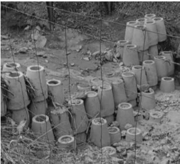
Fig. 6. Acumulación de sedimentos en uno de los diques dispuestos en la cárcava principal de la subcuenca piloto de Obejo.
