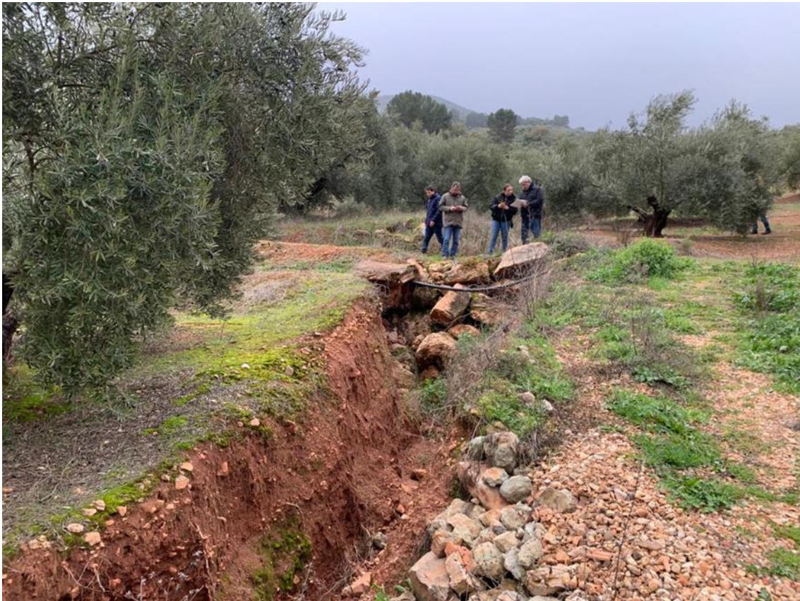
Figura 48. Cárcava situada aguas abajo, vistas hacia el camino y parcelas piloto.
